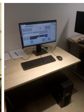
Stacja procesowania danych
